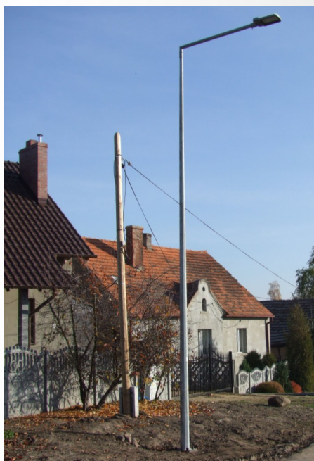
Nowa lampa uliczna w Rudnej Małej.
